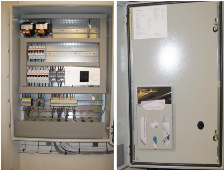
Fig. 1 – Eksempel på opbygning af automatiktavle med 1 stk. regulator og plads til fremtidig udvidelse.
